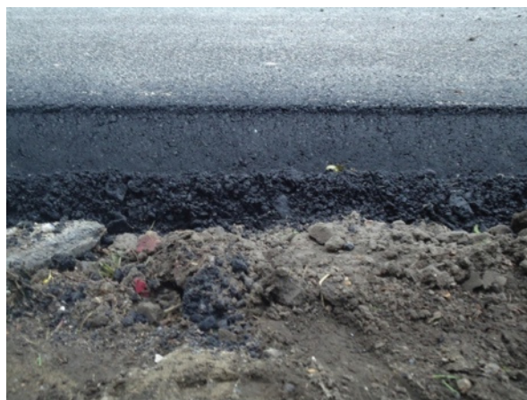
Bild 81: Unzureichende Kantenverdichtung an der B68
