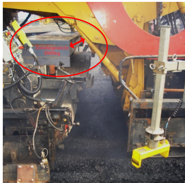
Bild 36: Unzureichender Abstand zwischen Bohlenauflast und Aufhängung der Deckschichtbohle
