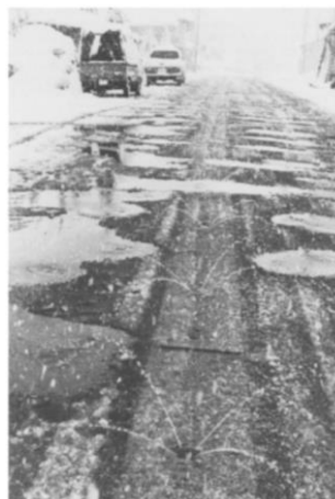
Abbildung 10: Shosetsu (Schneesmelze) Leitung [18]
