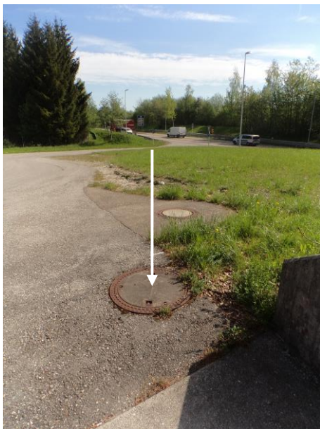
Abbildung 3: Lage Schacht mit festgestellten Versinterungen
