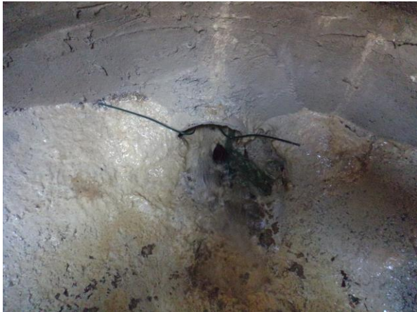
Abbildung 2: Versinterungen im Schacht vor dem Portal des Fluchtstollens [Lage siehe Abbildung 3]
